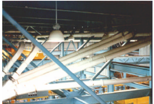
Ductos pasando por el techo
