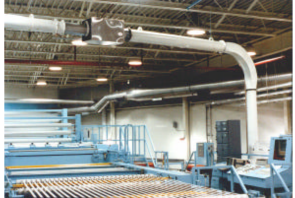
Ductos con el regulador de flujo de aire sobre el folio sheeter
